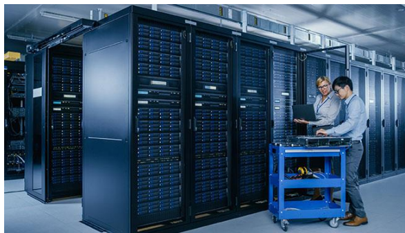
Image de serveurs dans un datacenter
